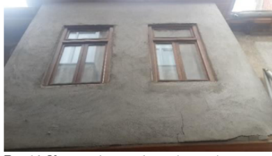
Fot. 14. Konağın batı cephesinde görülen çatlaklar (Çalın, 2015).
