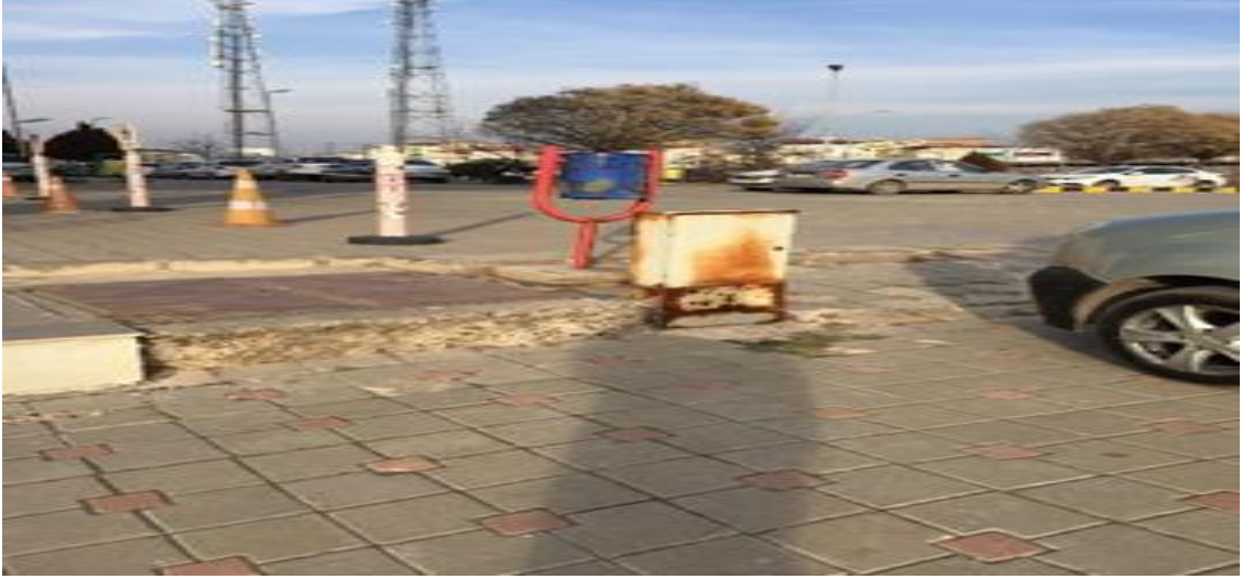
Şekil 2.4. Açık Otoparktaki Elektrik Panolarına Uyarı Levhası Asılması
