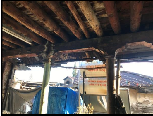
Şekil 3.18: İptal olan balkon kısmı (Aytemiz,2020)
