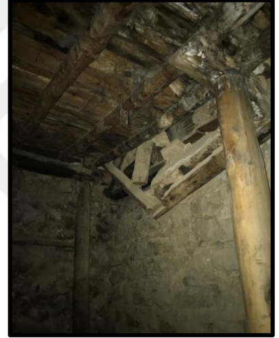
Şekil 3.23: Mutfak taban döşeme hasarı (Aytemiz,2020)
