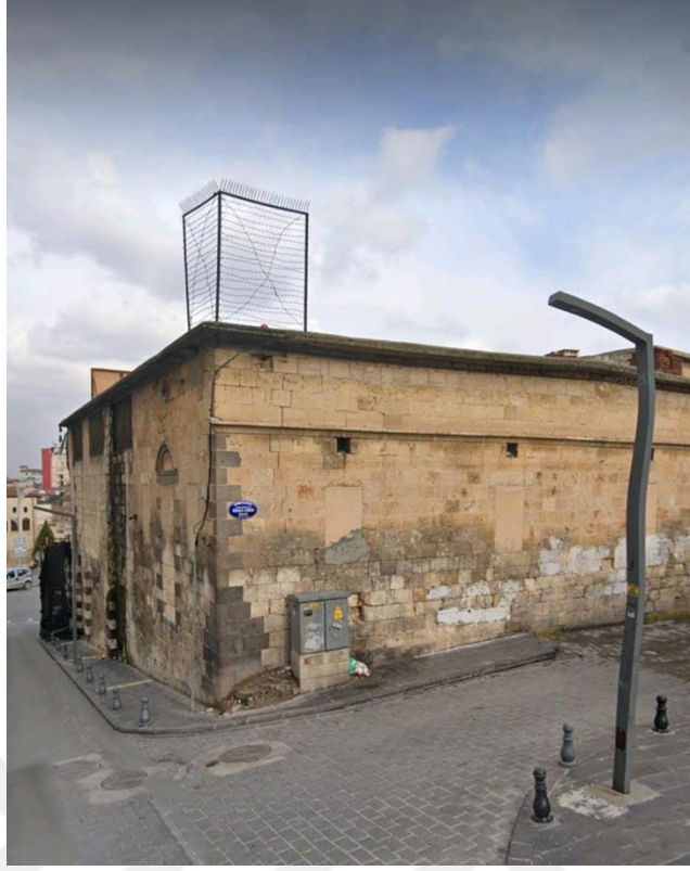
Şekil 8. 103. Restorasyonu Sürmekte Olan Vartanyan Anaokulu Abacı Emin Sokak Yan ve Arka Cephesi (Zaim E., 2020)
