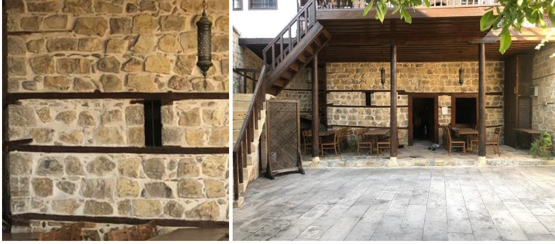
Şekil 4.42. Deligönüller Konağı'nda yer alan ahşap hatıllar.
