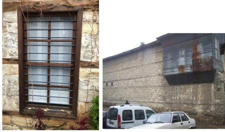
Şekil 4.44. Kocabaş Konağı, zemin kat pencere korkuluğu ve sac çıkma örneği (envanter no 98) (Özger, 2021).
