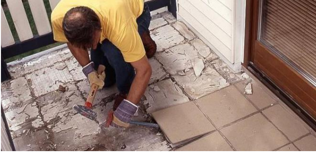
Şekil 2.4. Yenileme/onarım sonucu açığa çıkan yapısal atık örneği (URL-2)
