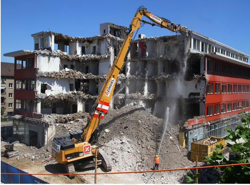
Şekil 2.5. Bir binanın yıkımı (URL-3)
