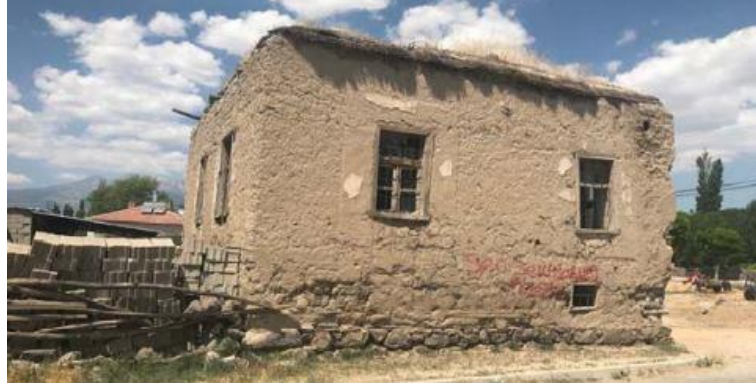
Şekil 2. 10. Kayseri, Yığma yapı, (Özcan, 2016)
