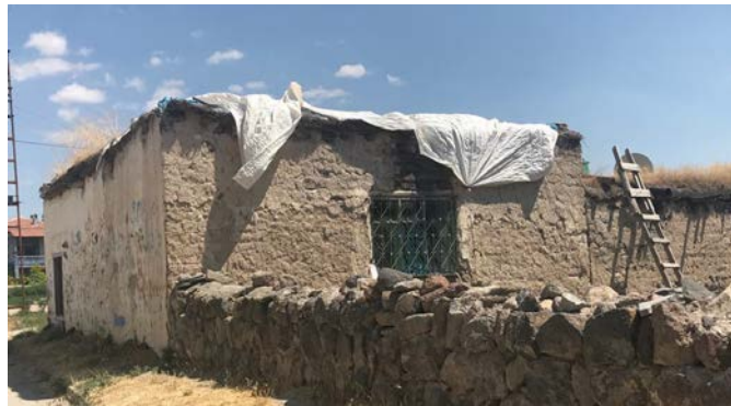
Şekil 4.56. Kayseri'de kerpiç bir yapıda mevcut imkânlarla yağmur suyu önlemi (P. Öztürk)
