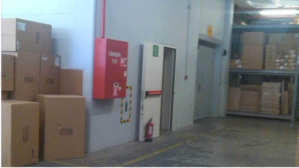
Şekil 5.19. Mobilya Deposunda Bulunan Yangın Dolabı, Yangın Söndürme Tüpü ve Yangın Alarm Butonu
