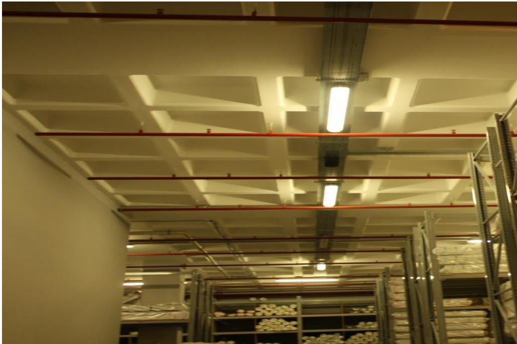
Şekil 5.20. Mobilya Deposunda Bulunan Sulu Yangın Söndürme Sistemi
