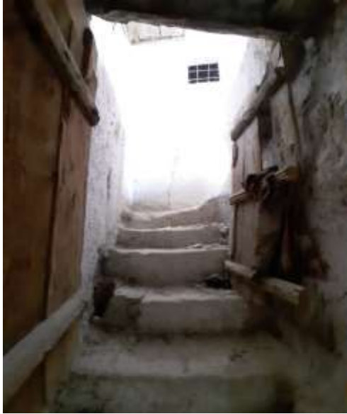
Şekil 5.7: I02No'lu odasındaki deforme olmuş kısımlar (2020)
