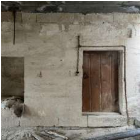
Şekil 3.49:Toprak kotuna yakın yerlerde su ve nemden kaynaklı derz boşalmaları (2020)
