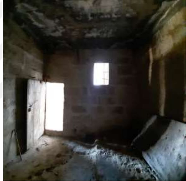
Şekil 5.8: I03No'lu odasındaki deforme olmuş kısımlar (2020)
