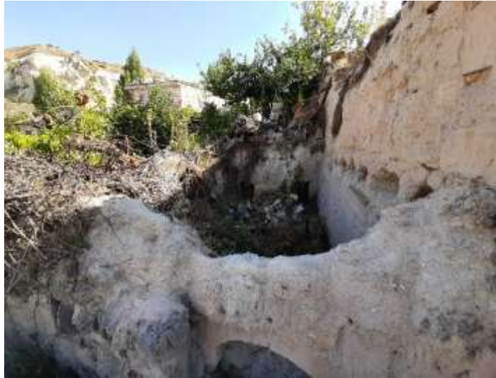
Şekil 3.45: B03 odasının tavanı yıkılmış hali (2020)
