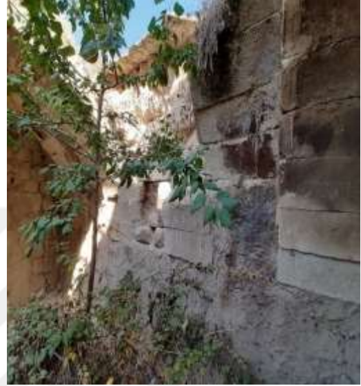
Şekil 5.6: Z07 Mahalinde Deforme Olmuş Kısımlar (2020)
