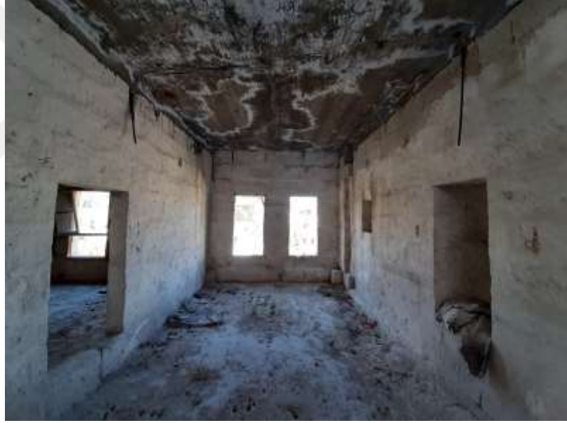
Şekil 3.23: I02'deki Tavandaki Deformasyonları (2020)
