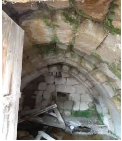
Şekil 3.48:Çatıdan su alan B01mahalinin tonozunda görülen nem problemleri (2020)
