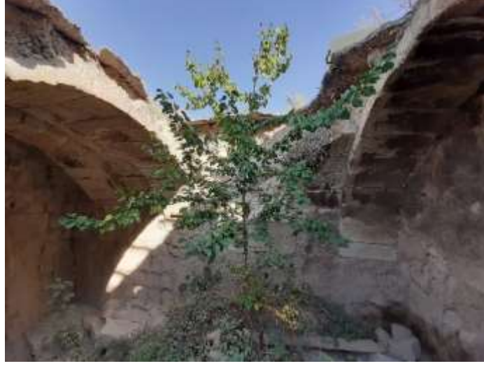
Şekil 3.46: +0.00 kot avluda bulunan Z07 odasının yıkılmış hali (2020)
