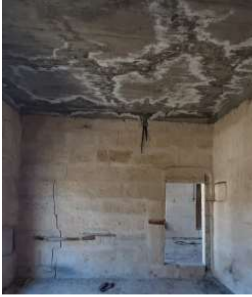
Şekil 3.47:I04mahalinin çatıdan su alması nedeniyle beton tavanda oluşan çürüme ve duvardaki çatlaklar (2020)
