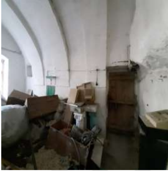
Şekil 5.5: Z04 Odadaki Deforme Olmuş Kısımlar (2020)
