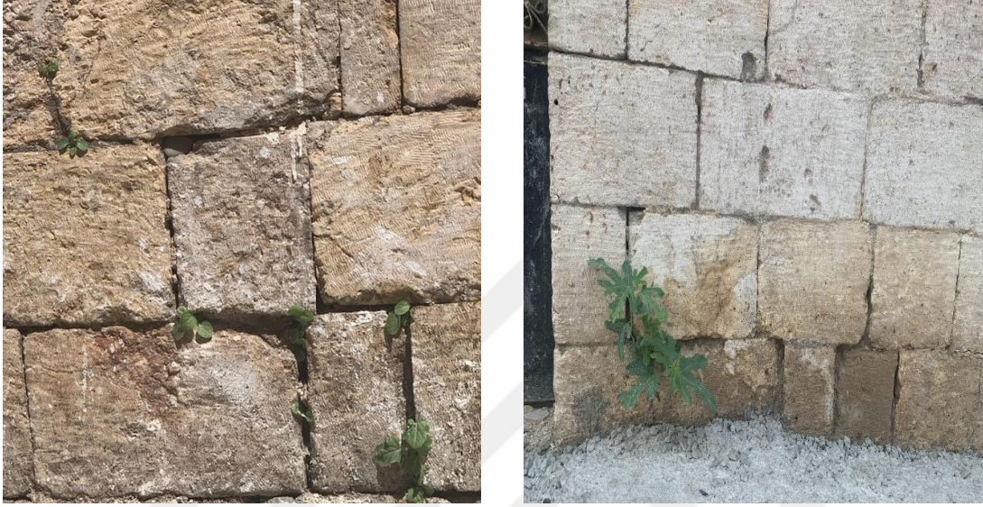
řekil 4.28. Nem etkisiyle cephe de grlen tuzlanma
