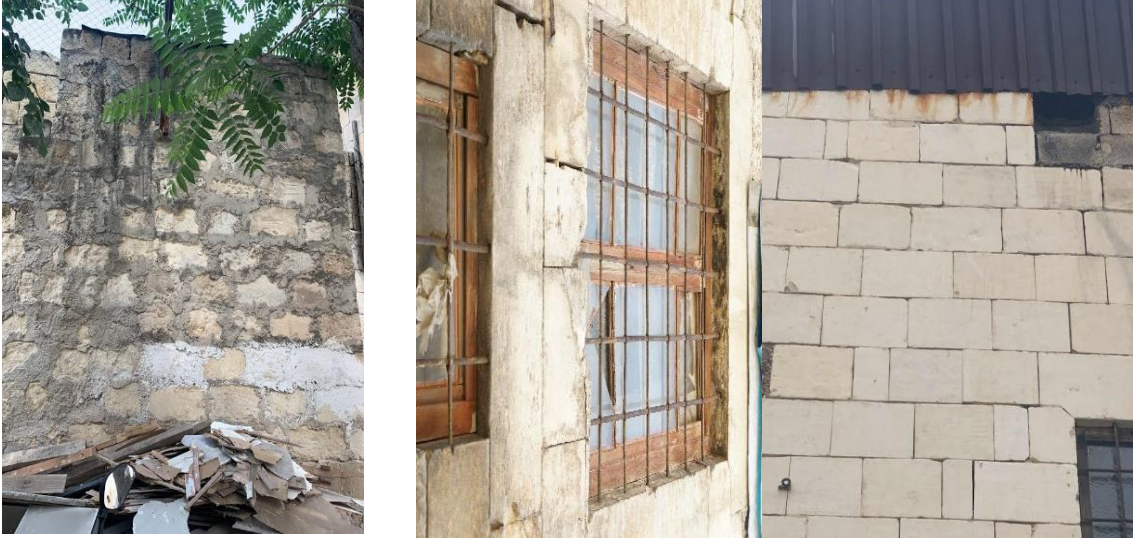
Şekil 4.32. Yapı yüzeyine uygulanan hatalı onarımlar
