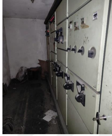
Şekil 19. Ana Elektrik Panosu
