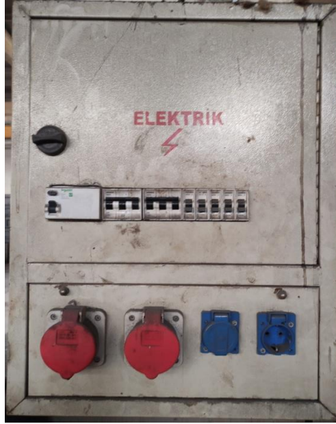
Şekil 18. Kaçak akım rölesi
