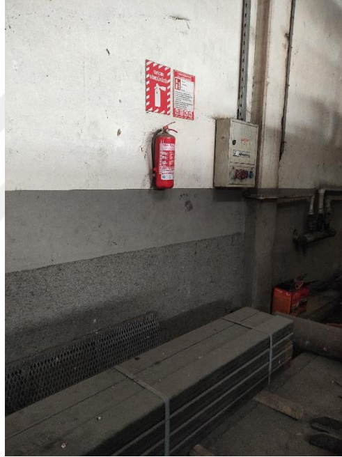
řekil 17. Elektrik panosu
