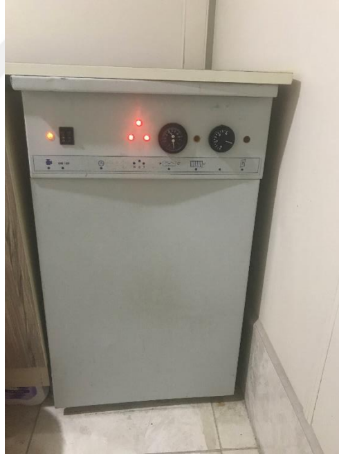
Şekil 6. Elektrikli ısıtma sistemi
