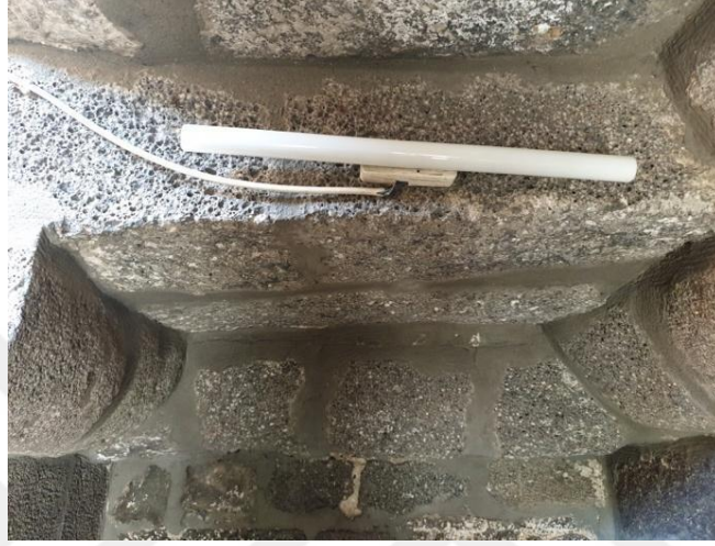
Şekil 5.68: Duvara sabitlenen floresan aydınlatma elemanı (Damar T. Fotoğraf Arşivi, 2020)
