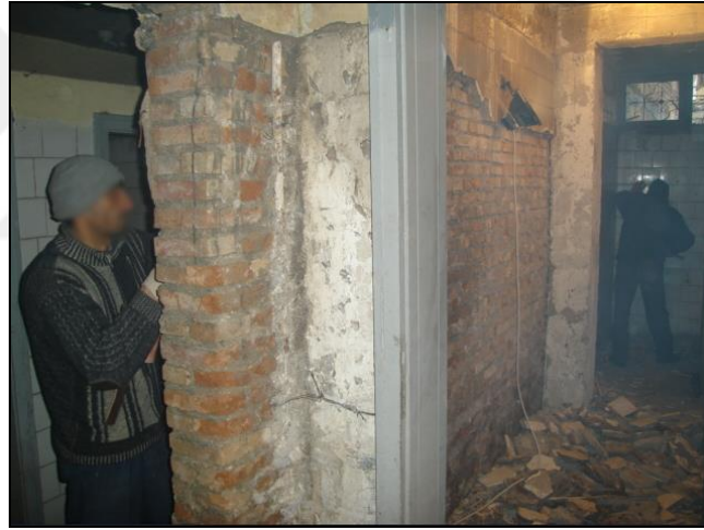
Şekil 3.8 Emine Göğüş Mutfak Müzesi Restorasyon Öncesi Eklenen Tuğla Duvar (Gaziantep KUDEB, 2008)
