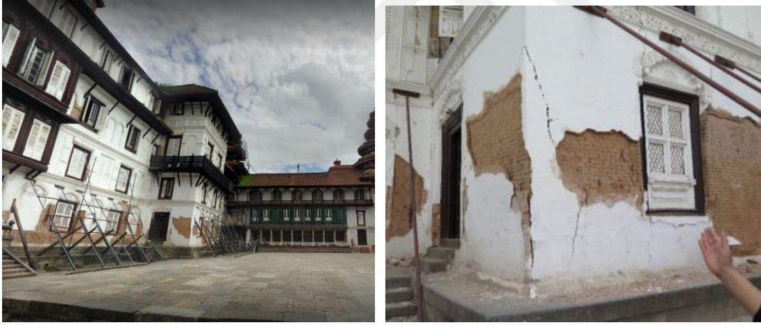
Şekil 3. 1. 2015 Nepal Depremi sonrası Hanuman Dhoka Sarayı'na uygulanmış olan yapı desteği örneği (Romao ve diğerleri, 2015)
