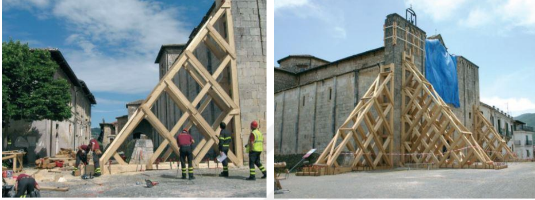
Şekil 3. 2. Sant'Eusanio Martyr Kilise'sine İtalyan Kılavuzu'na uygun yapılmış olan yapı desteği örneği (Grimaz, 2011)
