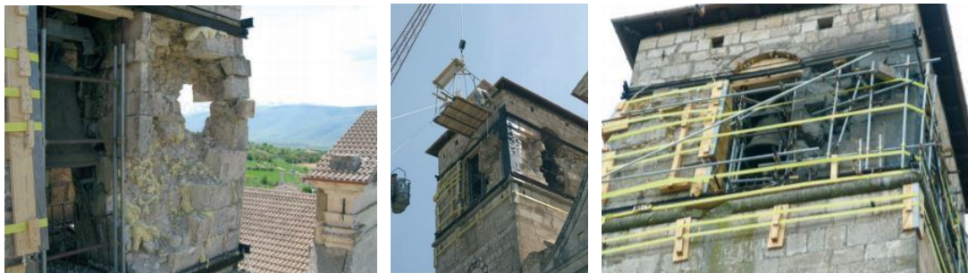
Şekil 3. 11. 2009 L'Aquila Depremi sonrası San Felice Martyr Kilisesi'nin bantlarla sarılması örneđi (Grimaz, 2011)
