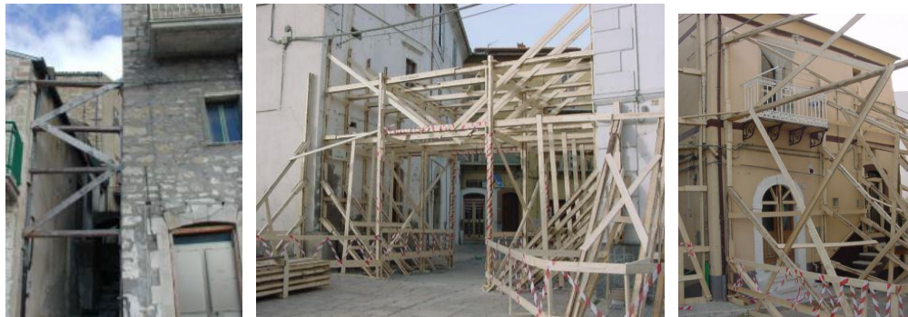
Şekil 3. 5. 2002 İtalya Molise Depremi sonrası uygulanmış olan yanlış yapı desteği örneği (Goretti, 2006)
