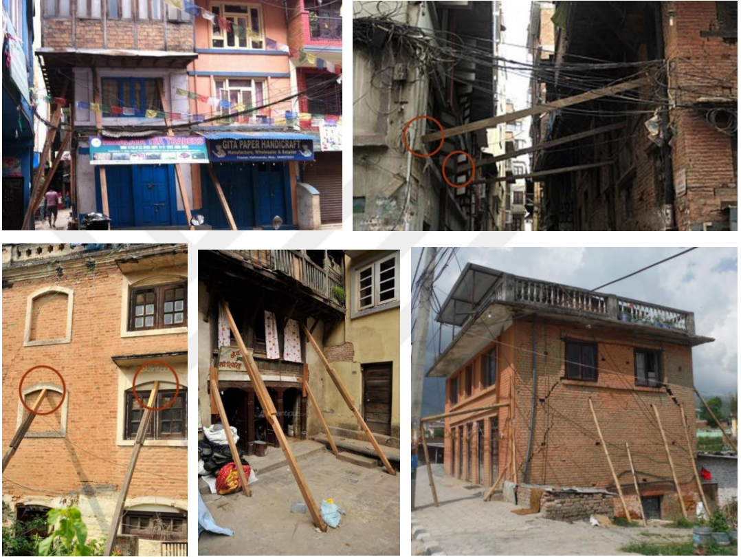
Şekil 3. 6. 2015 Nepal Depremi sonrası uygulanmış olan yanlış yapı desteği örneği (Pradhan, 2019)
