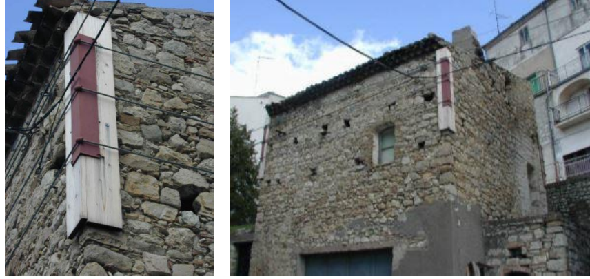
Şekil 3. 9. 2002 Molise Depremi sonrası yapının gergi çubuklarıyla sarılması örneđi (Goretti, 2006)
